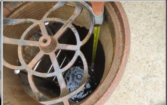
B-5 Sta.147+27.0(이토) 밸브실 침수(H=4.5m)
