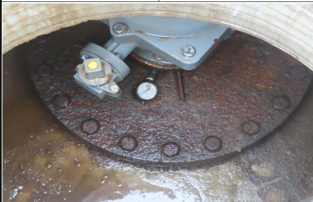
B-7 Sta.207+10.0(공기) 플랜지 표면부식
