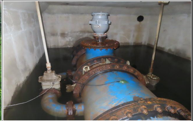
B-7 Sta.186+0.0(제수) 플랜지 표면부식
