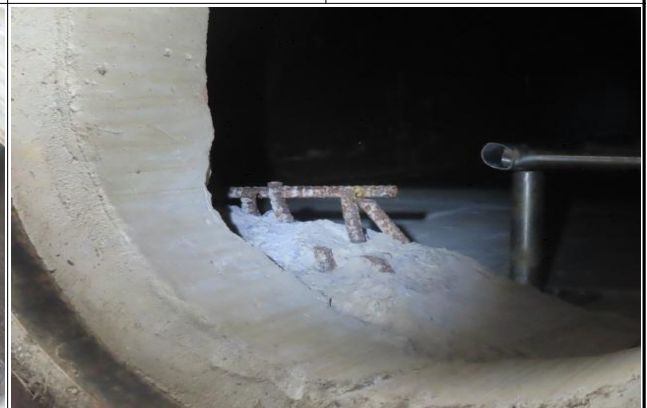
B-8 Sta.228+26.0(이토) 벽체 철근노출
