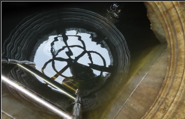
B-4 Sta.95+9.0(이토) 밸브실 침수(H=2.0m)
