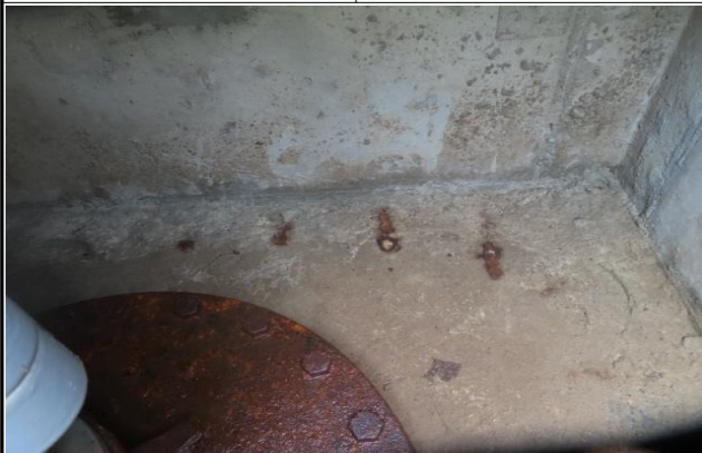
B-5 Sta.116+11.0(공기) 하부슬래브 철근노출
